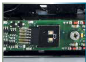
Entstörersatz eingebaut / Installed interference suppression set
